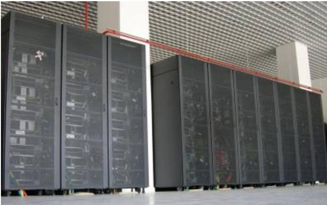
Ilustración 2: Detalle de las instalaciones de Magerit (Fuente: Cevima)
