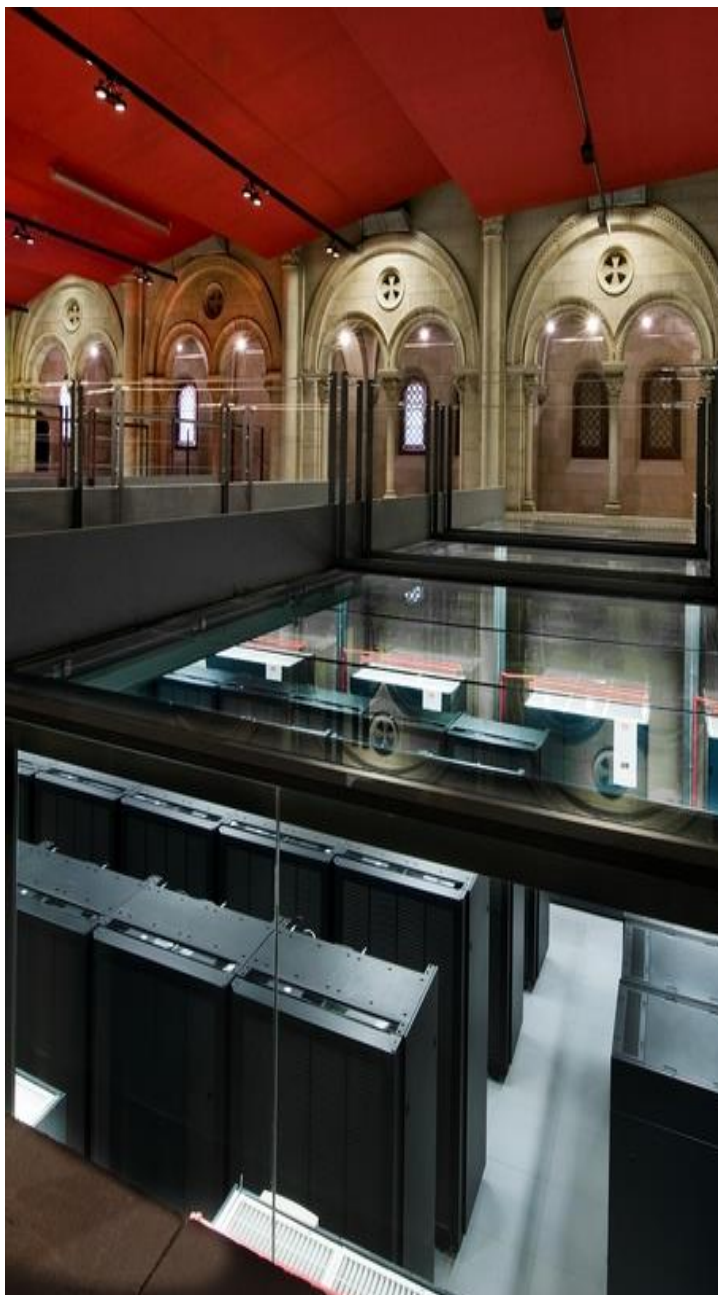
Ilustración 1: Instalaciones del ordenador Mare Nostrum (detalle de los 52 rack y 120 m 2 ) Fuente: www.bsc.es
