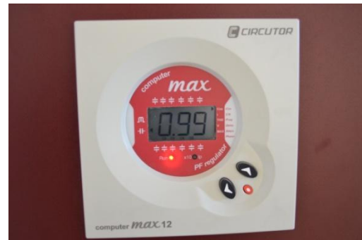
Control de potencia reactiva
