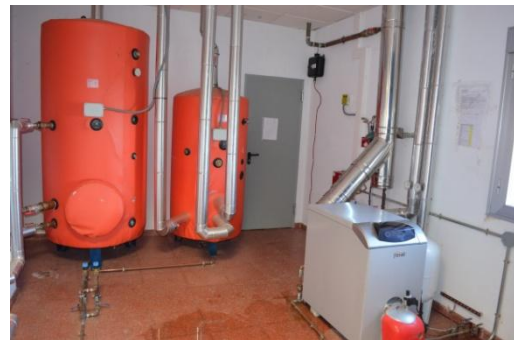
Acumuladores y caldera
