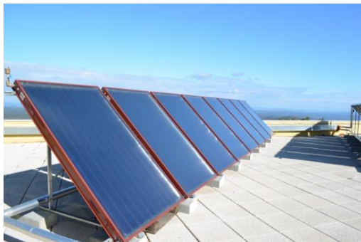
Placas solares térmicas
