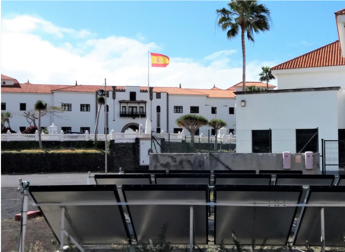
Figura 6. Instalación fotovoltaica en el Acuartelamiento El Fuerte (isla de La Palma). Fuente: 5ª Subinspección del ET.
