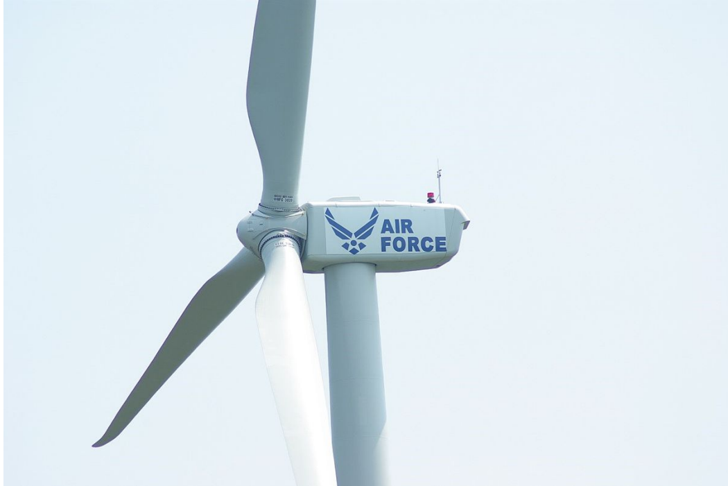
Figura 7. Aerogenerador de la Fuerza aérea de EE. UU. en la Base de Cape Cod (Massachusetts) 16 . Fuente: US Air Force.
